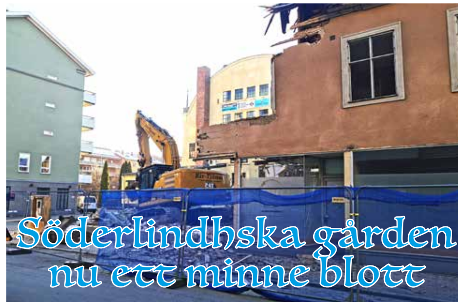
Denna del av Söderlindhska gården på Nygatan var oskadad efter branden. Ändå revs den.
